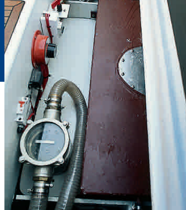
Vorbildlich: stabiler Einbautank, Batteriehaupschalter und Seewasserfilter.
